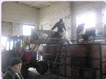
Процес завантаження НП в установку для знищення небезпечних відходів («Елга», м. Шостка)
