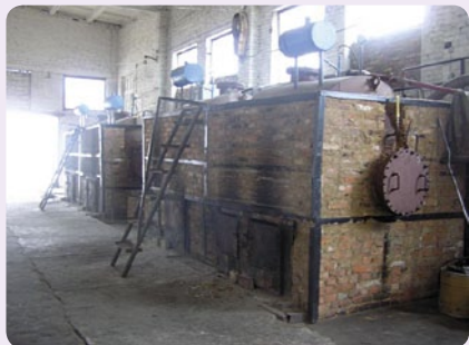
Загальний вигляд установки для знищення небезпечних відходів («Елга», м. Шостка)
